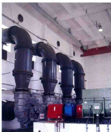
山东潍坊电厂2×30万kW 机组600X-TLR型脱硫泵使用现场
