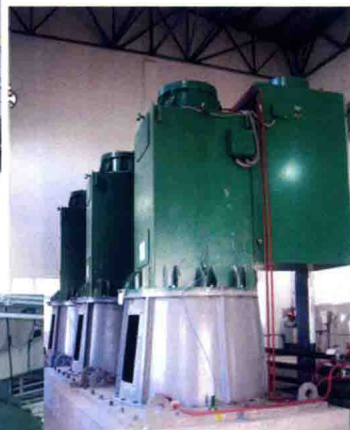
华能威海电厂2×30万kW机组 海水脱硫系统1200VXL海水循环泵
