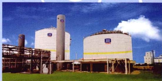
5000 m 3 低温液体贮槽
