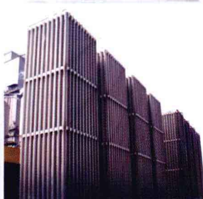
■ 沙钢现场8台6250m 3 /h大型汽化器
