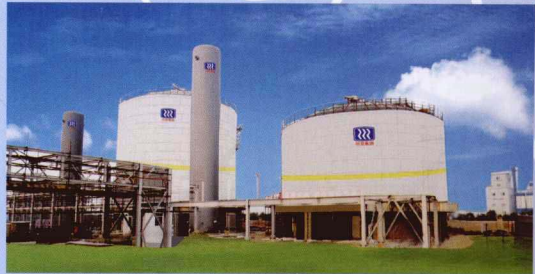
5000 m 3 低温液体贮槽
