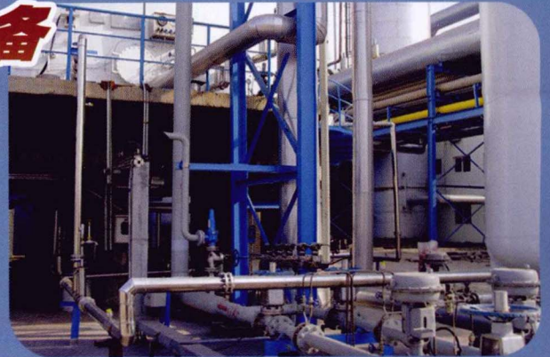
使用中的高真空低温绝热管道
