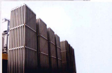
■ 沙钢现场8台6250m 3 /h大型汽化器
