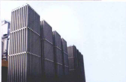
■ 沙钢现场8台6250m 3 /h大型汽化器
