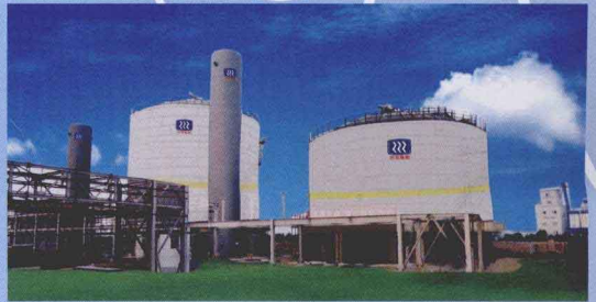
5000 m 3 低温液体贮槽
