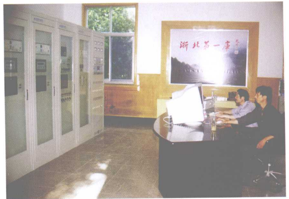
赋石水库电站中控室
