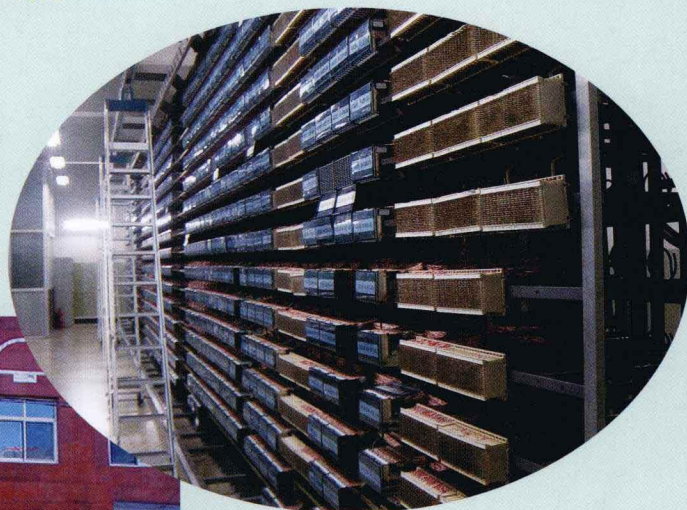
丰台电话局测量室总配线架
