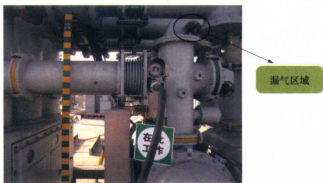
图 1-1 44200-1 隔离开关气室照片
