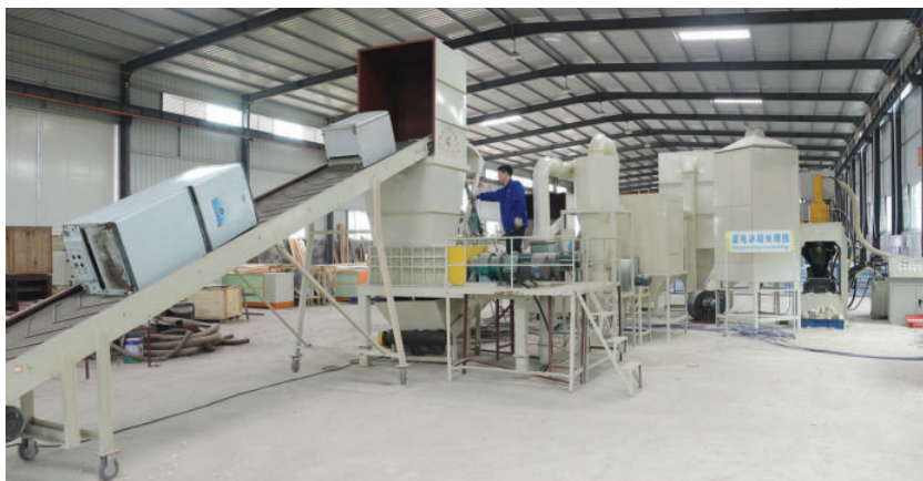
“废弃电子产品资源化系列成套设备研发与产业化”项目获江西省科学技术进步一等奖。图为废旧电冰箱破碎回收成套设备 温礼明 摄
