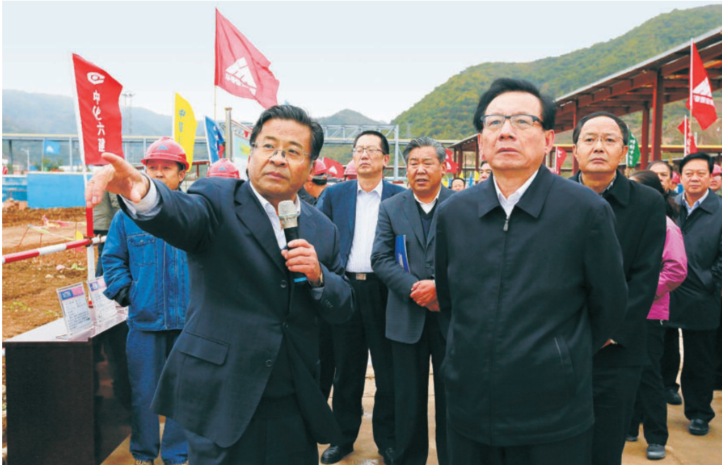
2014年10月11日，甘肃省政协主席冯健身（中一）在20万吨/年聚丙烯项目施工现场调研
