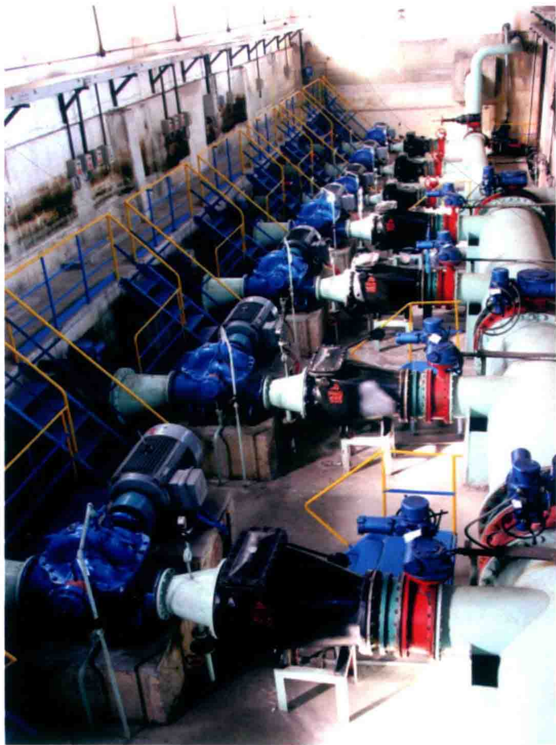
2005年4月，运行中的贵州铝厂氧化铝废水处理系统
