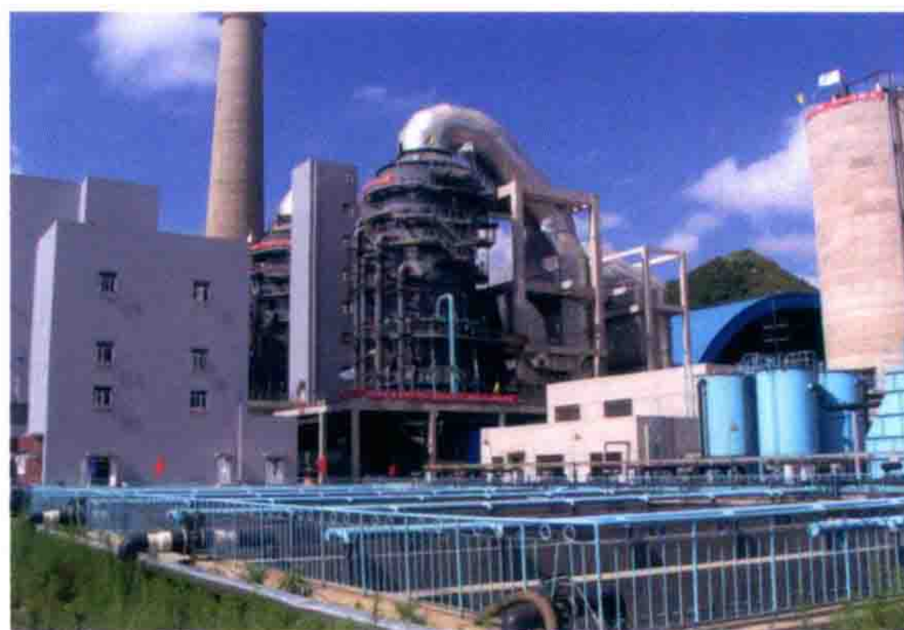
2005年7月，运行中的贵阳发电厂2×200M机组烟气脱硫设施
