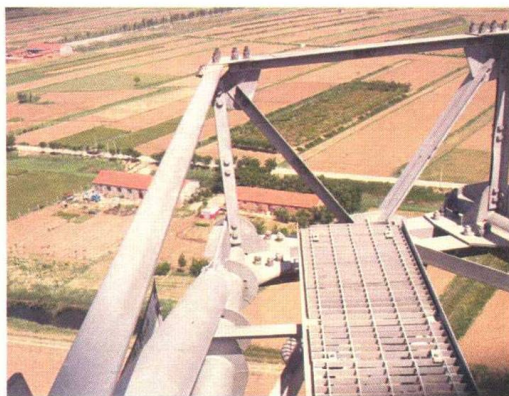
图2-2-2 塔材正常状态
