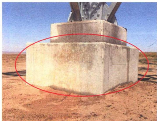
图1-5-1 基础回填土不足
