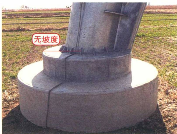
图1-2-1 基础保护帽散水坡度不足
