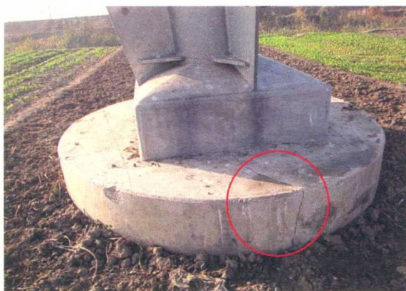
图1-4-1 基础立柱面开裂
