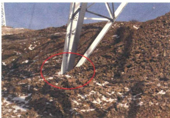
图1-6-1 杆塔塔脚被埋
