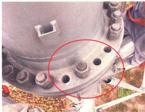
图2-1-1 法兰盘螺栓缺失
