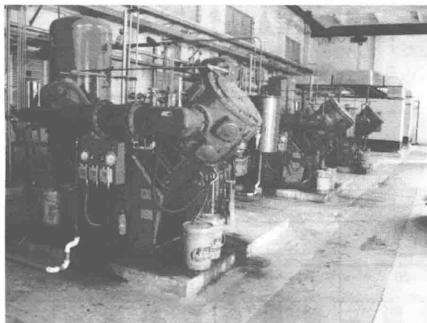
图 1-22 A 公司工厂空压机房
