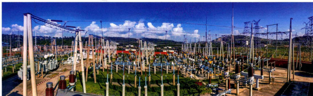
110 千伏城南变电站
