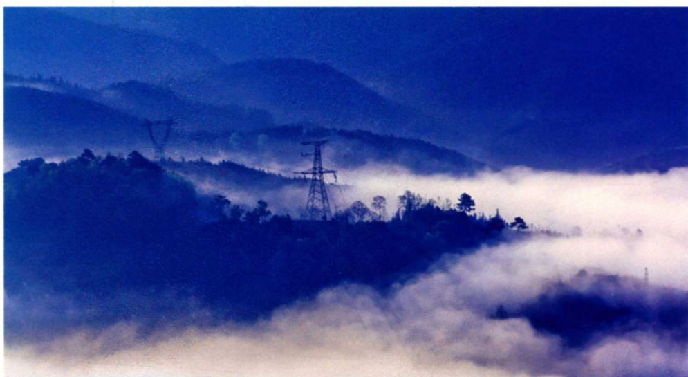
110 千伏鲁兴 输电线路
