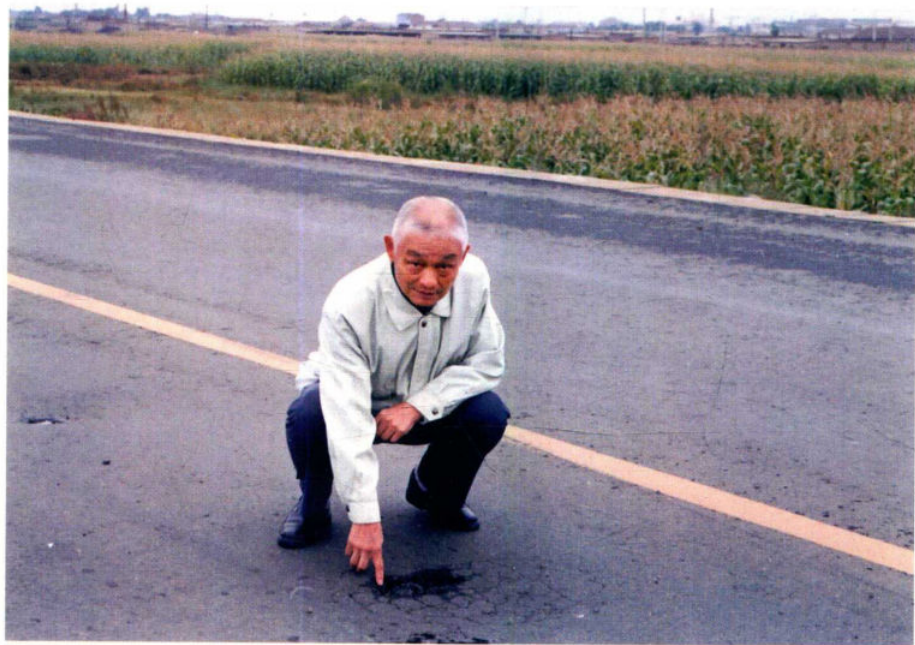
2002年在高速公路上察看路面产生的龟裂和坑洞
