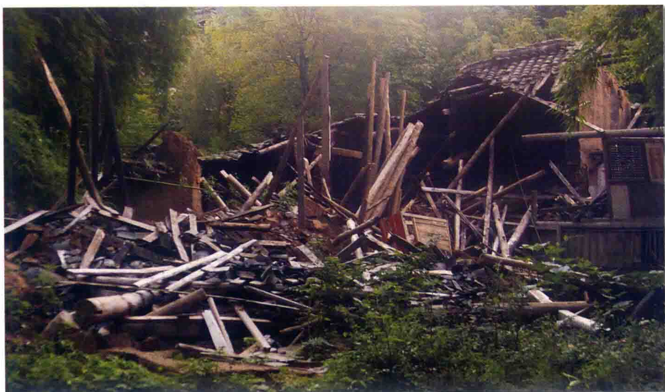
毛坝乡民房垮塌
