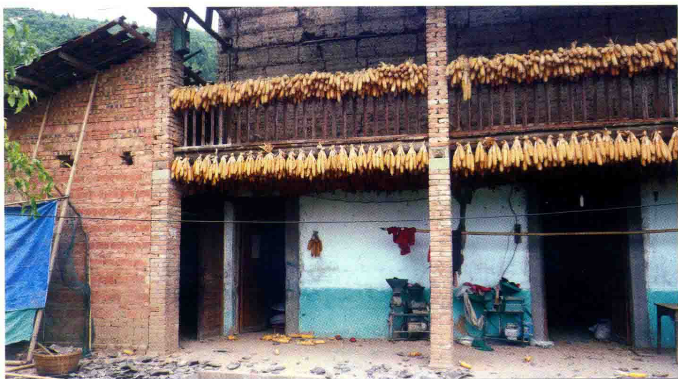
元山镇民房损毁
