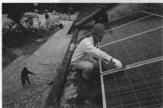
图 1-5 农村太阳能光伏电站
