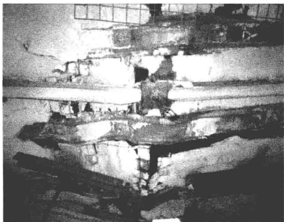
图 1-4 浆皮脱落、钢带变形
