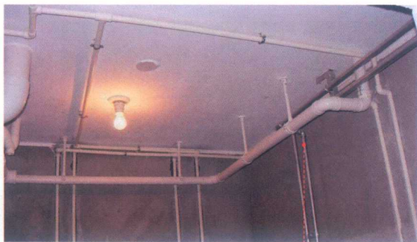
竖着走水管不会破坏墙面的稳固度 墙面走水管
