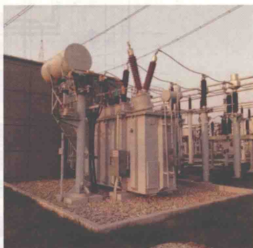
图 1.1-6 南京换流站 110 kV 站用变
