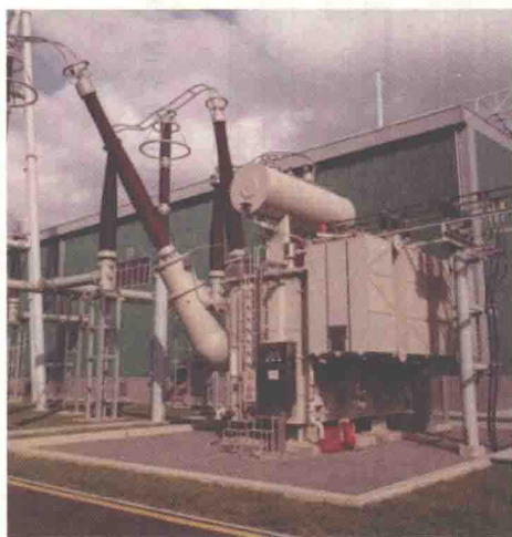
图 1.1-5 南京换流站 500 kV 站用变
