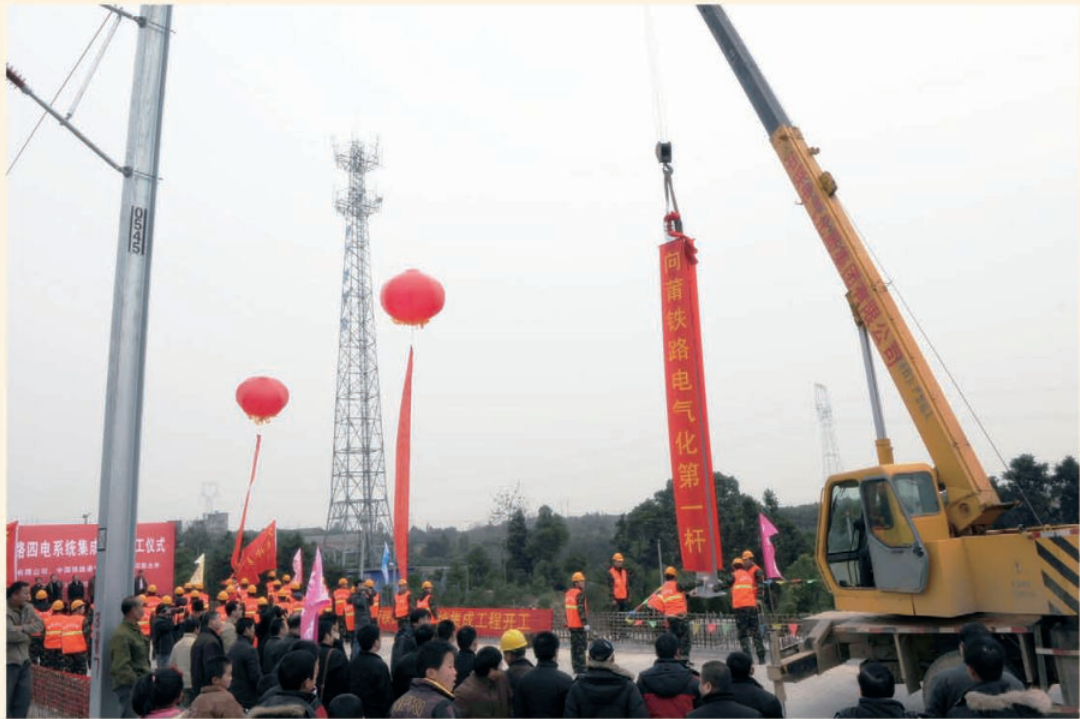
2009年12月26日，向莆铁路电气化第一杆在招贤特大桥立起。（陈亮摄）
