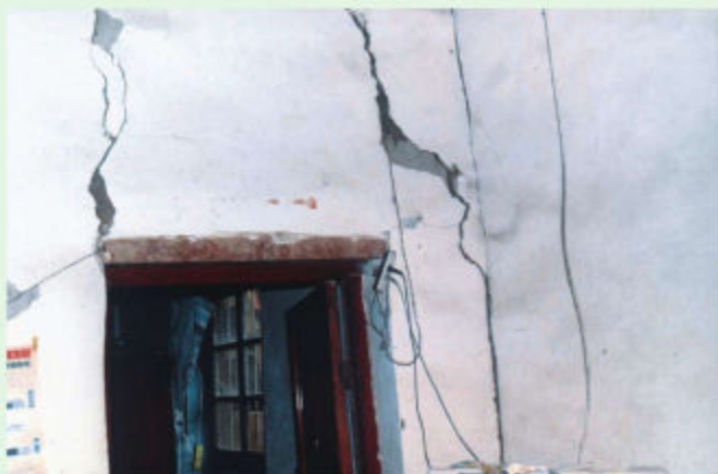
震中区砖混墙体开裂
