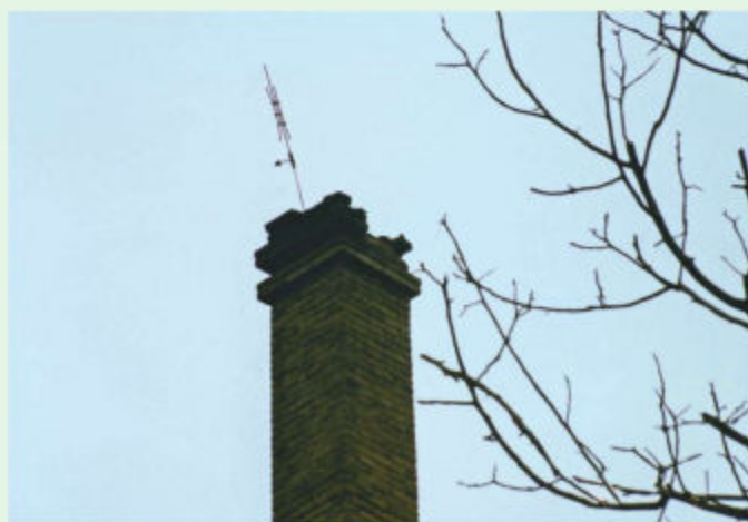
咸阳市泾阳县雪河乡政府灶房烟囱上部震落
