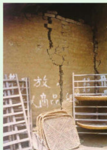
震中区一户村民家土木墙体严重破坏
