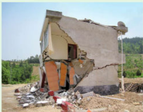
汉中市宁强县广坪镇金山寺村一房屋在5月25日6.4级余震后被毁坏（2008年5月26日摄）
