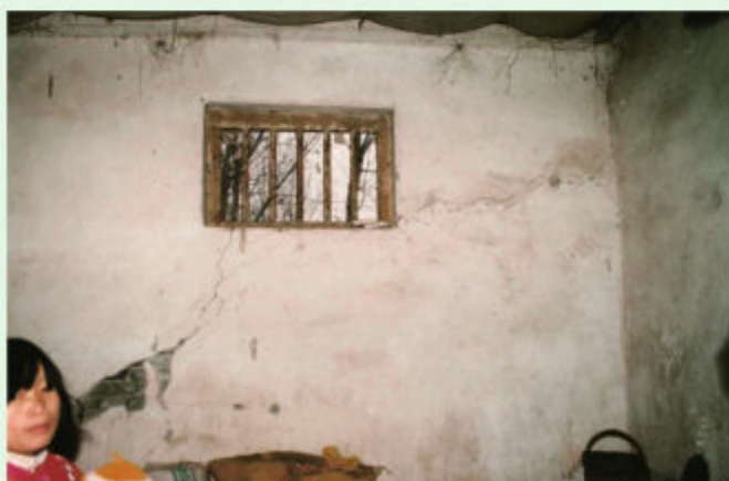
咸阳市泾阳县高庄乡金田峪一户村民家砖墙开裂
