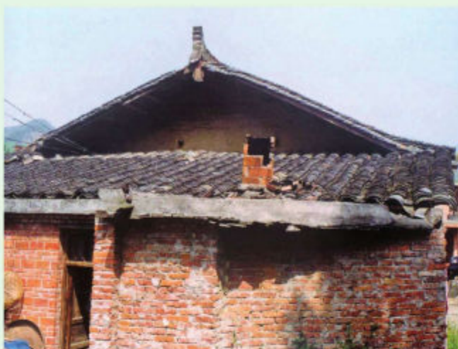
震中区一户村民家烟囱倒塌
