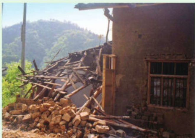
震中区土坯房屋严重破坏
