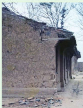
咸阳市泾阳县蒋刘乡徐家堡村小学一土木结构房屋西山墙砖瓦震落
