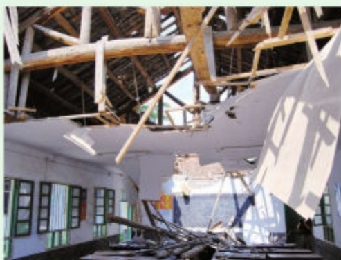
汉中市宁强县毛坝河镇中心小学砖木结构的校舍严重破坏(2008年5月16日摄)
