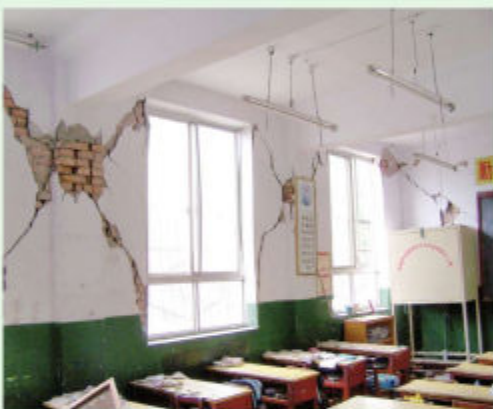
汉中市略阳县城关镇嘉陵小学砖混结构校舍严重破坏(2008年5月13日摄)
