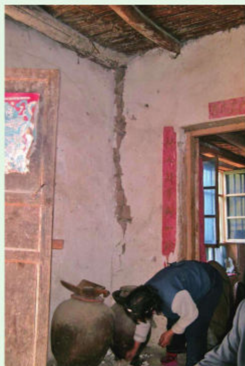
震中区一户村民家土木墙体裂缝
