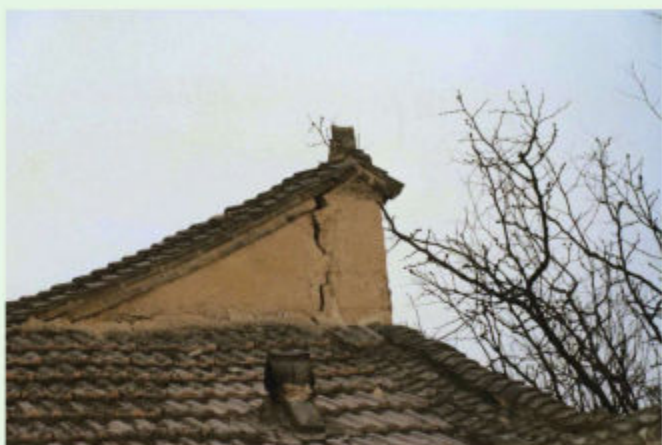
咸阳市泾阳县高庄乡 金田峪一户村民家土墙裂缝
