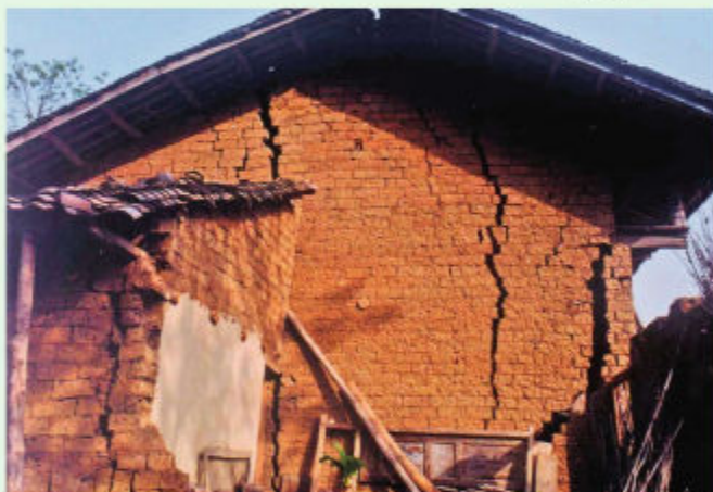
震中区土坯房屋严重破坏
