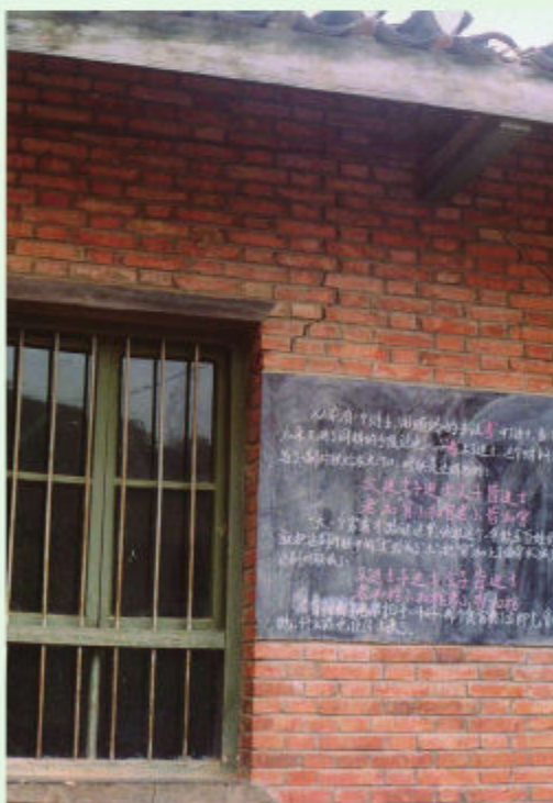
石泉县红卫乡红卫小学砖混墙体裂缝
