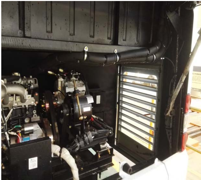
图 0-3 压缩机安装位置
