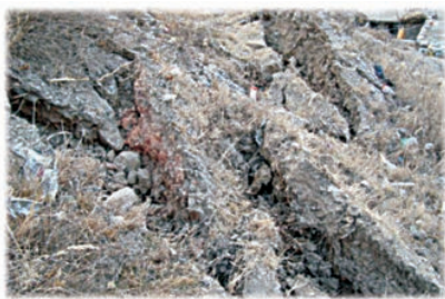
宕昌县官鹅村牙坪社崩塌
