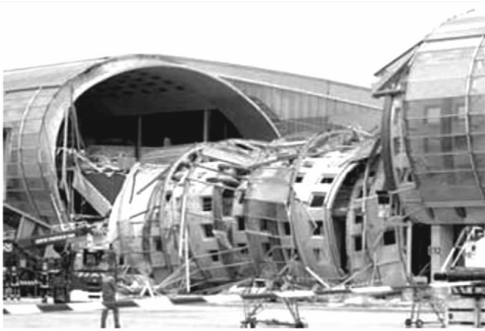
(a)戴高乐机场候机厅倒塌
