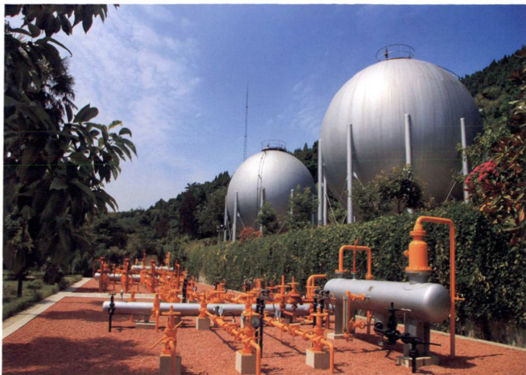
天然气储配站
