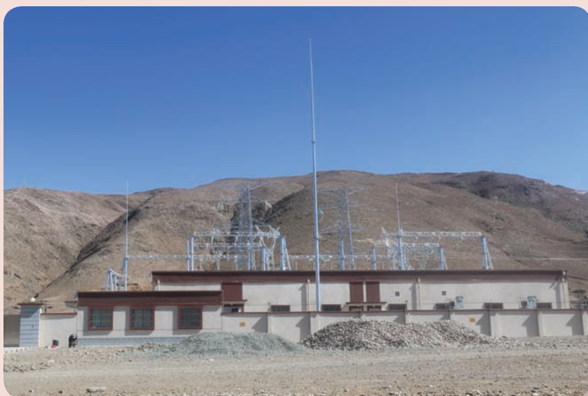
2016年7月1日，曲松县110千伏变电站正式投入使用
