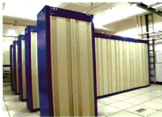
县电信局机房
