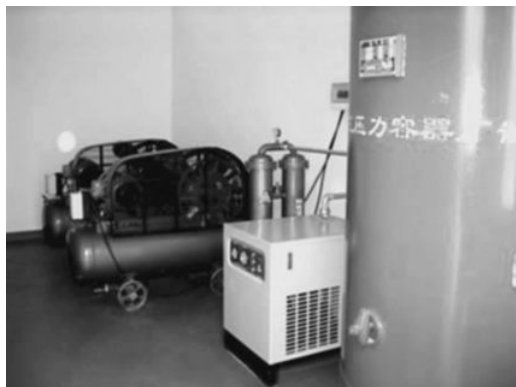
图 1-10 空气压缩机房
