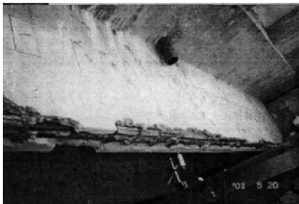
图 1.5 桥梁混凝土脱落、露筋
