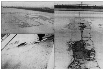
图 1.3 桥面铺装脱落
