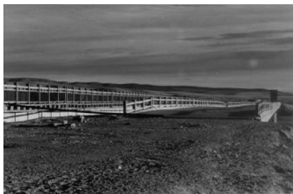
图 1.4 桥梁扭曲变形
