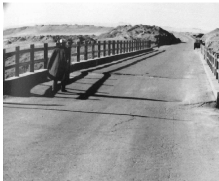
图 1.2 桥台下沉引起桥面折裂和倾斜
