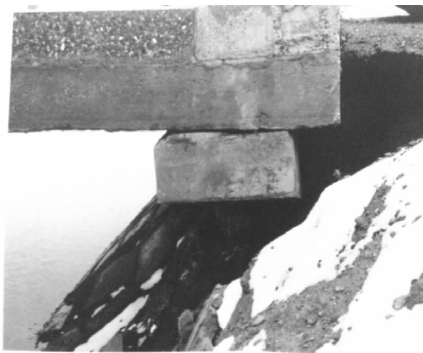
图 1.1 地基融沉引起桥跳
