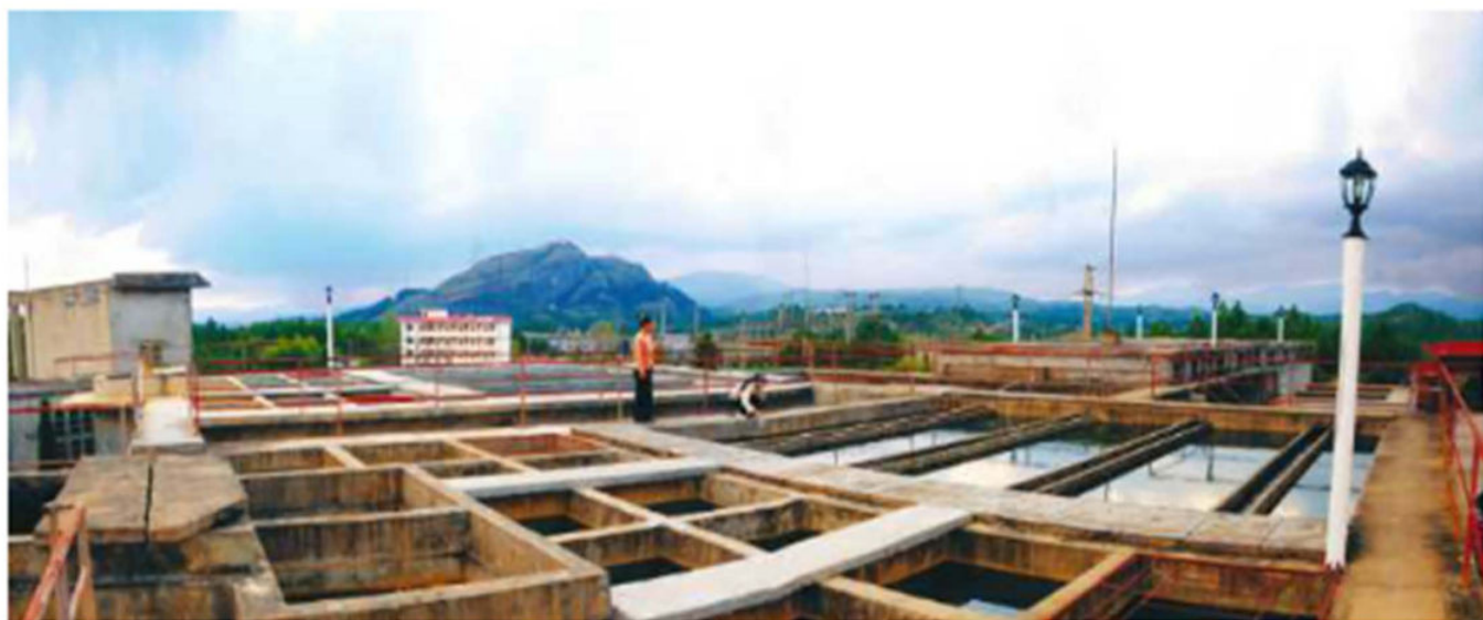
城乡供水一体化设施
