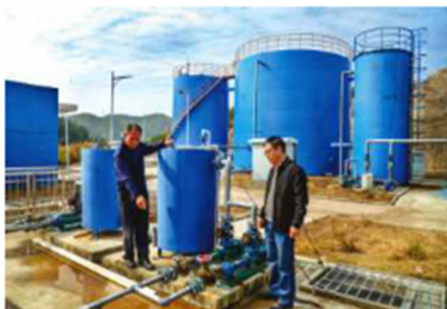
城乡垃圾一体化填埋场污水处理设施 温礼明 摄
