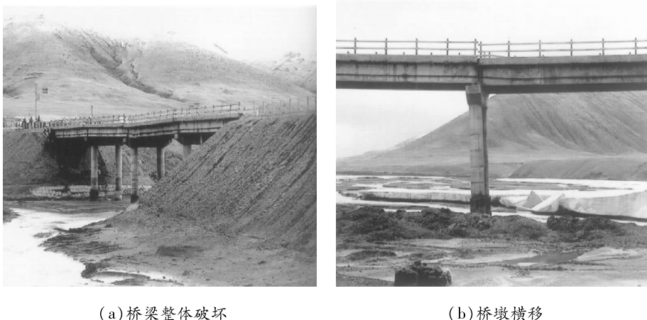
图 1-1 冻土区常见工程病害
