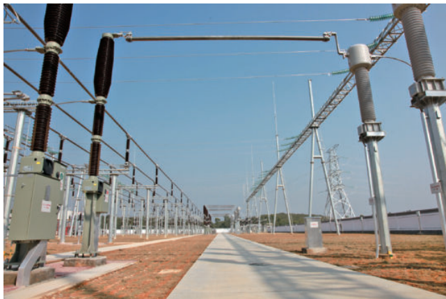
2013年12月27日，220千伏那务输变电工程竣工投产，标志茂名电网北部双环网格局形成，信宜、化州、高州大面积停电风险得到有效化解，供电安全性、可靠性进一步提高，惠及80.4万用户
