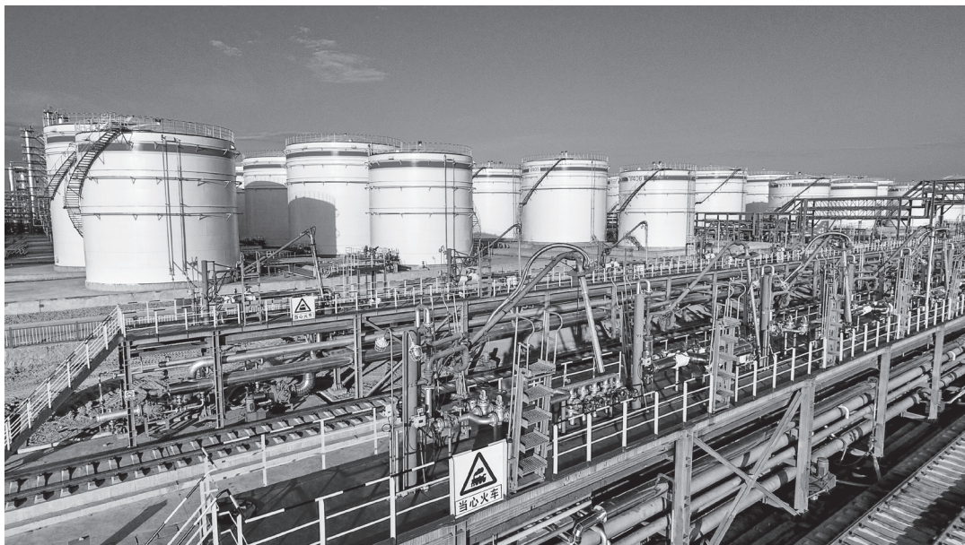
宁夏宝利新能源有限公司拥有西北地区最大的35万立方米存储罐区
