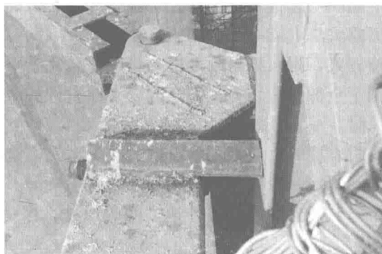
图 1-8 调节螺杆折断，安装人员焊一根角钢抵在塔身主肢上
