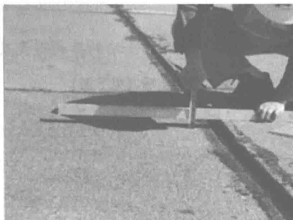
图 1K411010-5 水泥混凝土路面错台
