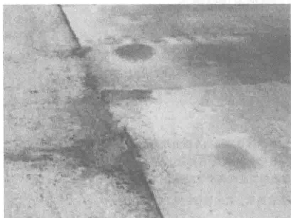
图 1K411010-4 水泥混凝土路面唧泥
