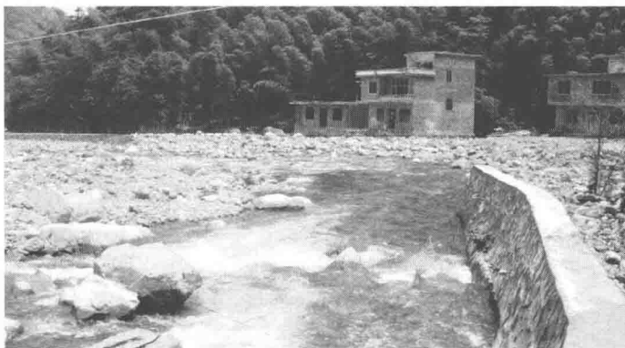
图 1-4 汾阳县洪水冲毁河堤
