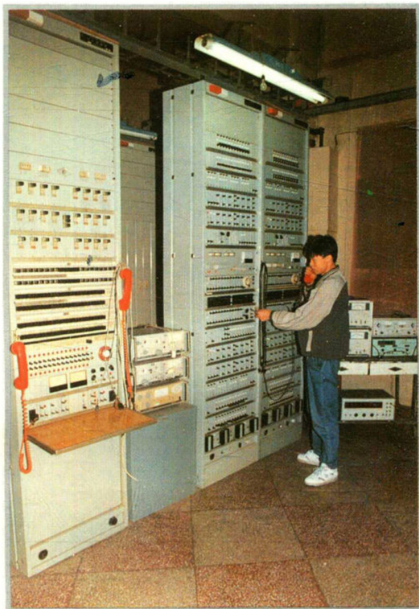
程控电话机房一角
