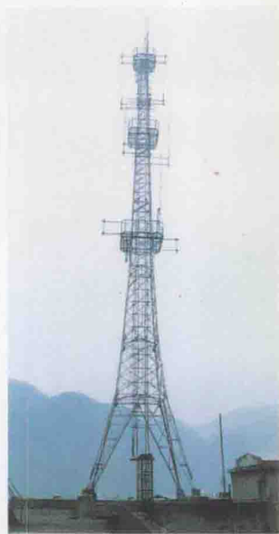
▲移动电话铁塔
