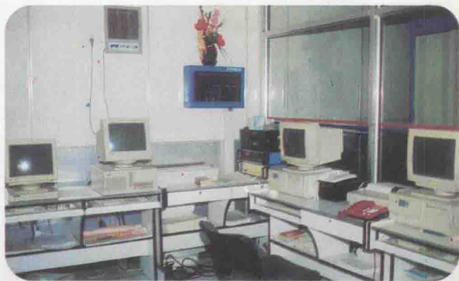
▶自动机房控制室
