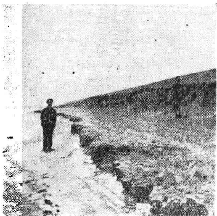
昌图县红顶山水库大坝迎水坡未护砌 被风浪淘刷成陡坎
