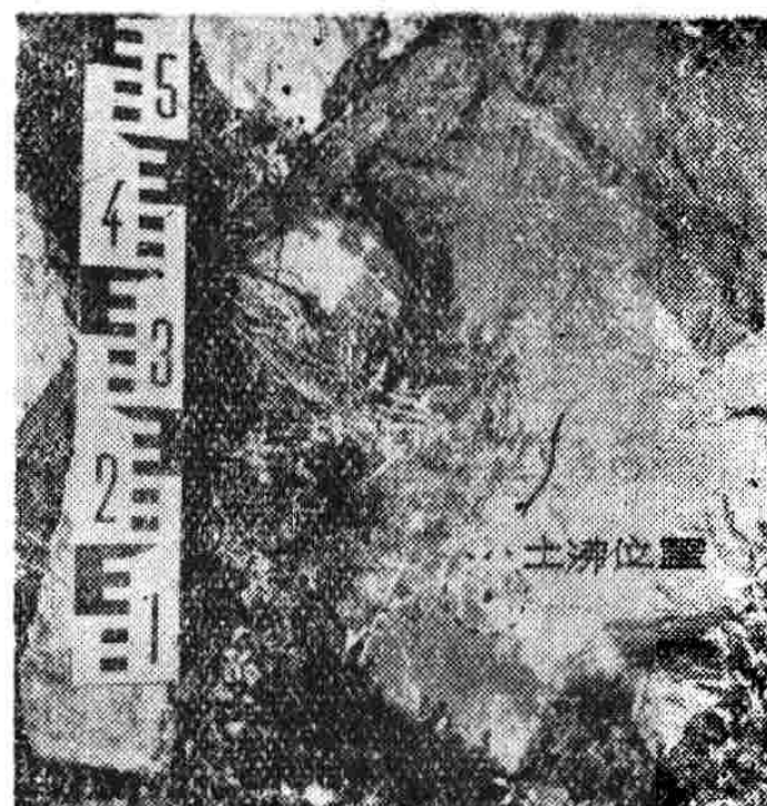
昌图县红顶山水库滤水坝址 下游 1.0 米处土沸现象
