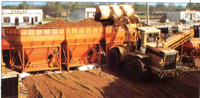
现代化的沥青混凝土拌和设备
