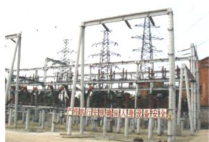
110千伏达县三里坪变电站
