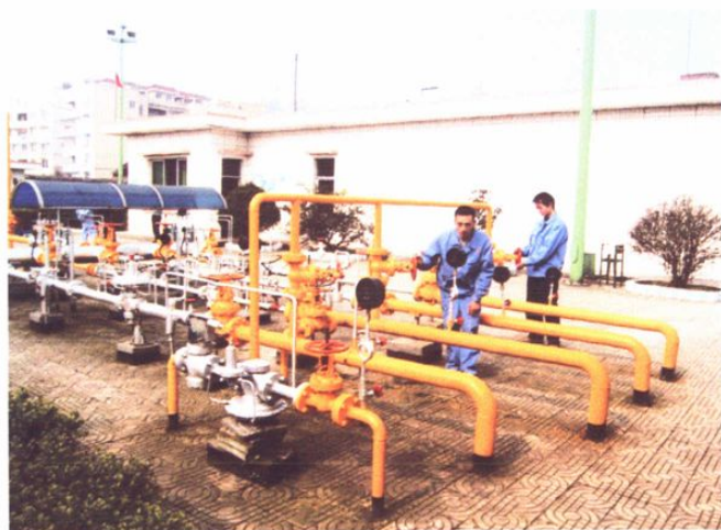
县城天然气配气站
