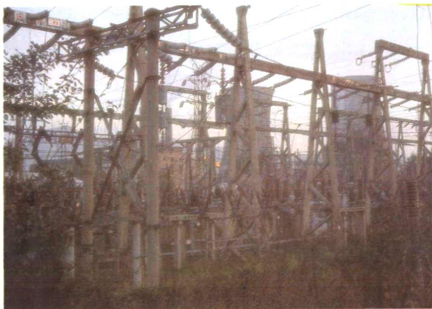
二道江变电所
