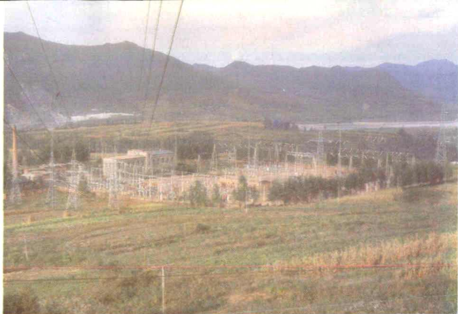
水洞一次变电所
