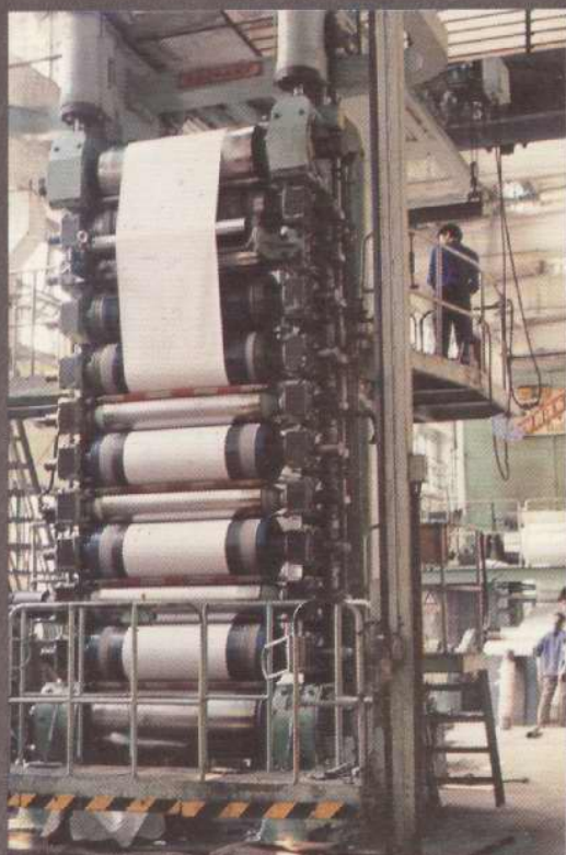
重慶造紙廠從德國引進的超級壓光機
