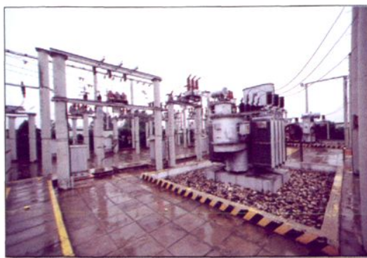
上郭35千伏变电站
