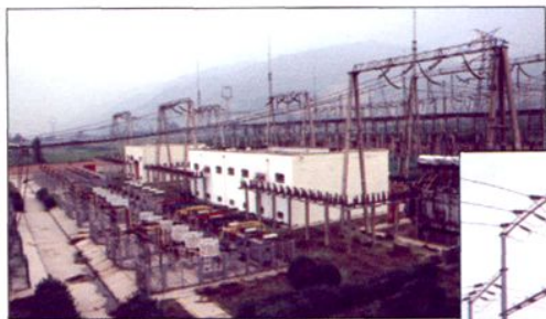
桃园220千伏变电站
