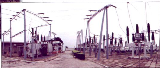
罗义110千伏变电站
