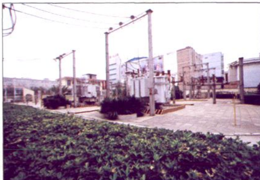
东郊35千伏变电站
