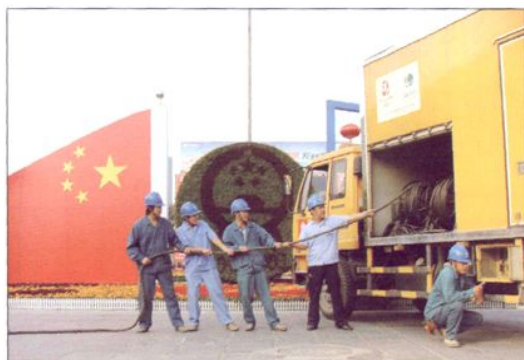
2009年盐湖供电公司迎祖国60华诞全力保电
