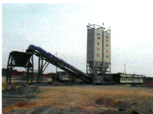
▲水泥混凝土搅拌站
