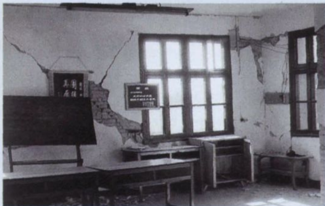
11.6地震勐勐镇 办公大楼严重受损
