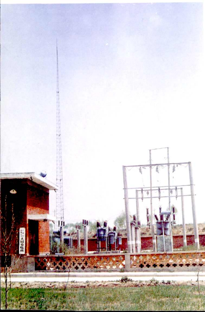
农村供电网大同变电所
