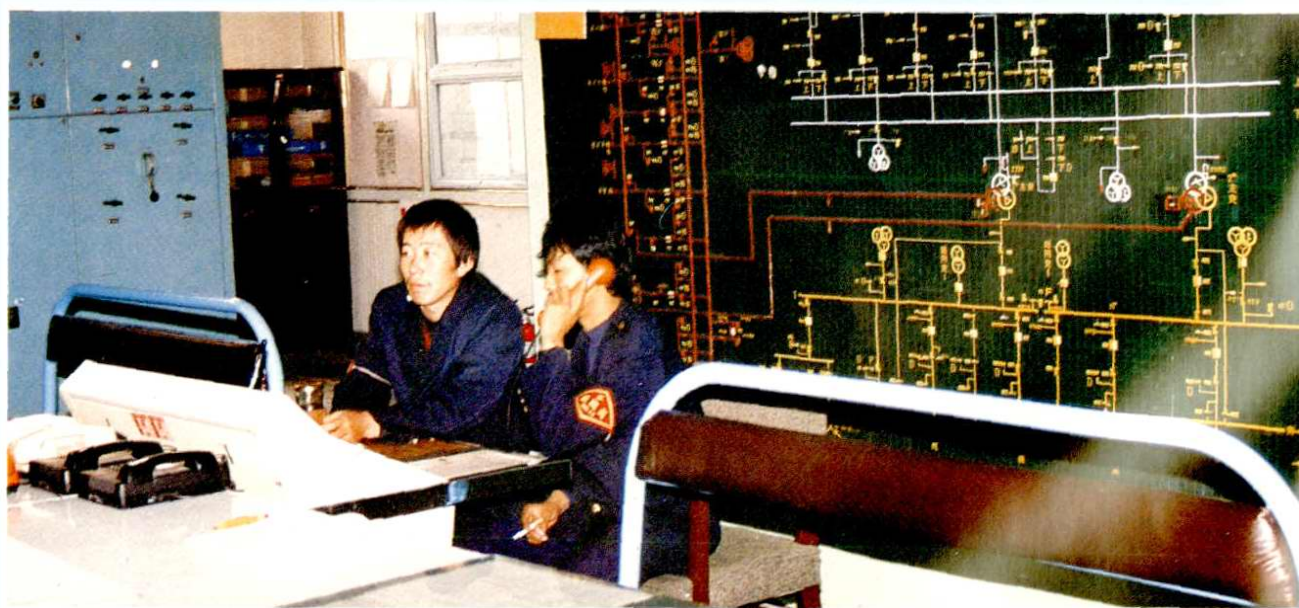
变电站值班人员正在工作
