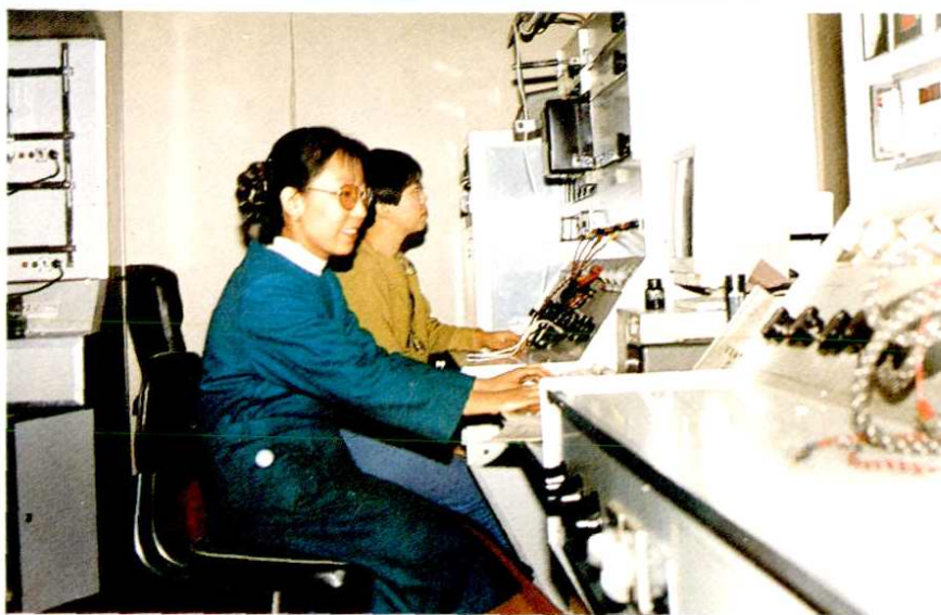
地区调度所通信总机值班室
