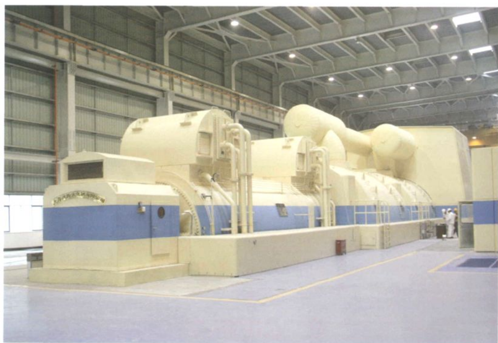
浙江国华宁海发电厂发电机组
