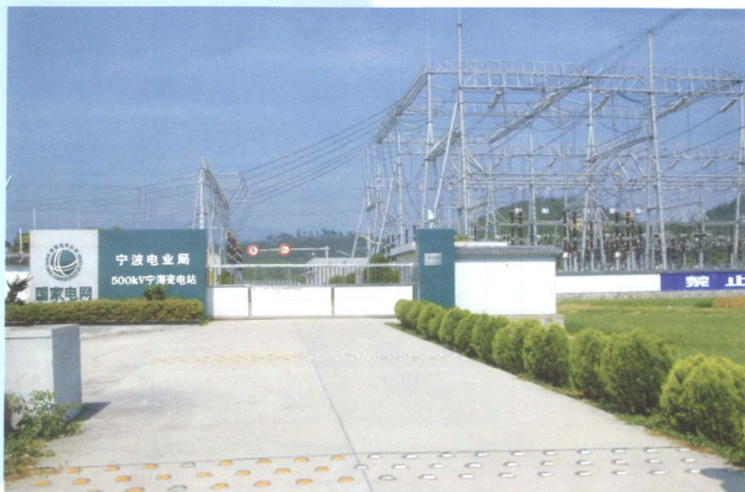
500 千伏宁海变电所
