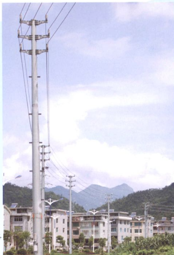
10 千伏配电线路
