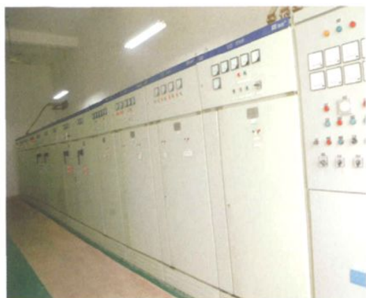
浙江卫信生物药业有限公司开关室
