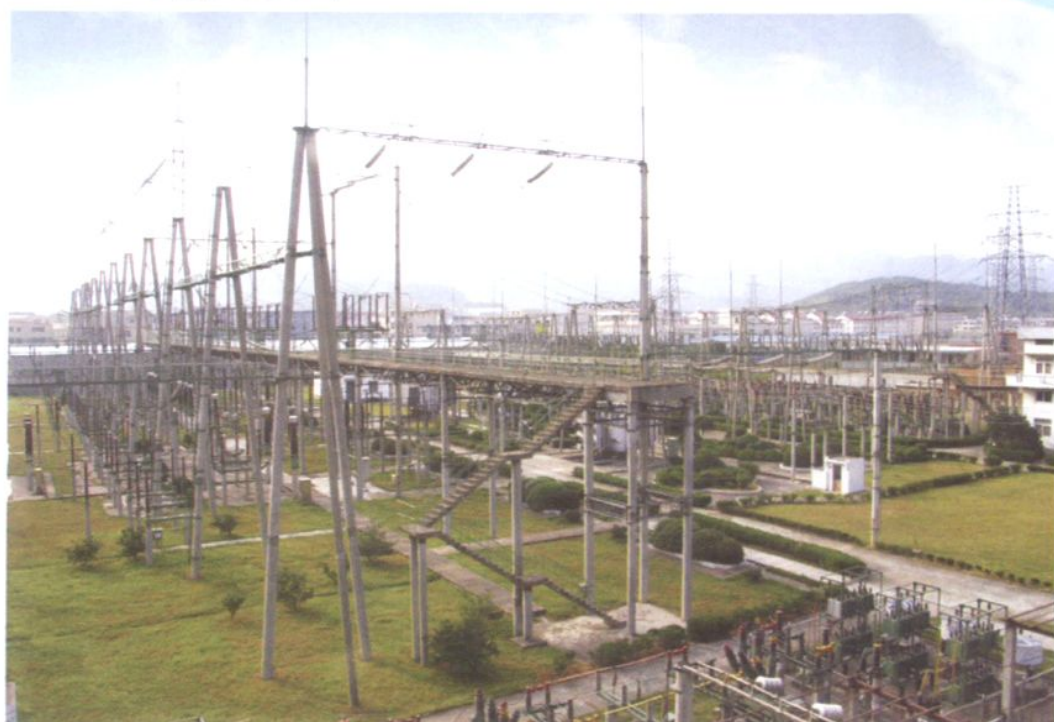
220 千伏跃龙变电所户外设备布局
